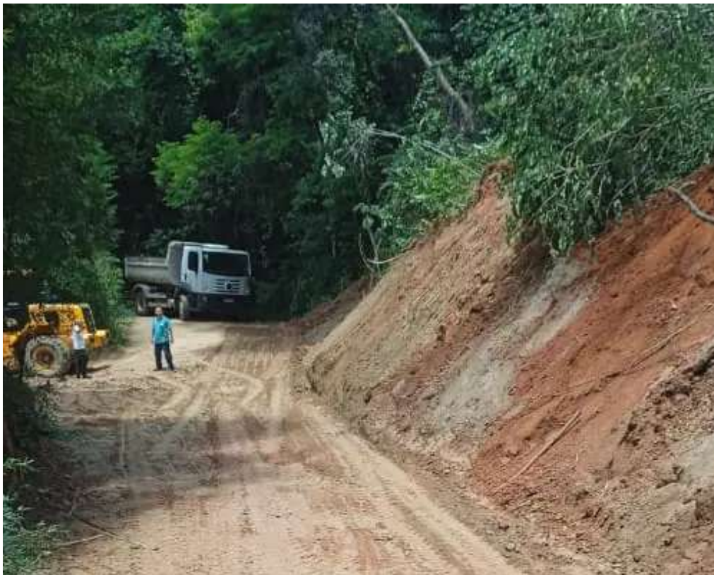
Figura 59 – Deslizamento ocorrido no Município de Lavrinhas.
