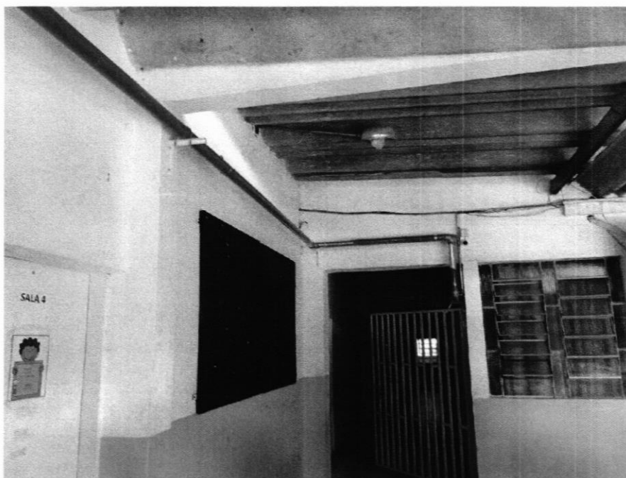
Foto 01 – AVCB Escola Júlio Fortes.
