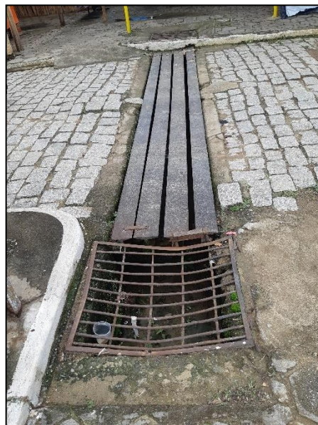
FIGURA 76 – BOCA DE LOBO PRÓXIMA A PRAÇA CAPELA DO JACU FONTE: ACERVO DO AUTOR, 2021
