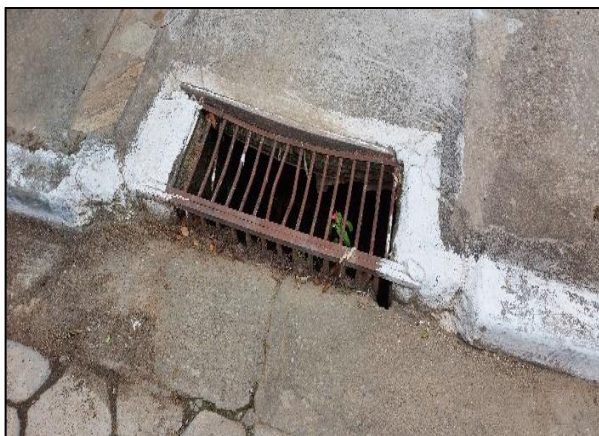
FIGURA 77 - BOCA DE LOBO NA FRENTE DO CRAS FONTE: ACERVO DO AUTOR 2021
