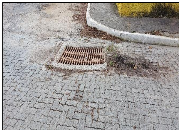
FIGURA 78 - BOCA DE LOBO NA ESQUINA DO CONSELHO TUTELAR FONTE: ACERVO DO AUTOR 2021
