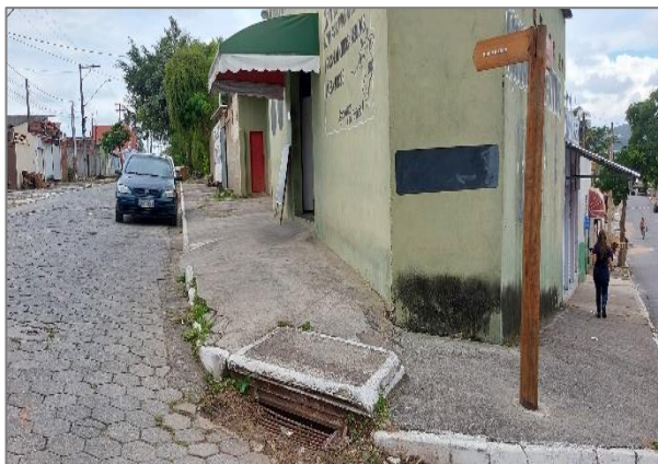
FIGURA 163 - BOCA DE LOBO NA ESQUINA DO MERC VITINHO FONTE: ACERVO DO AUTOR 2021
