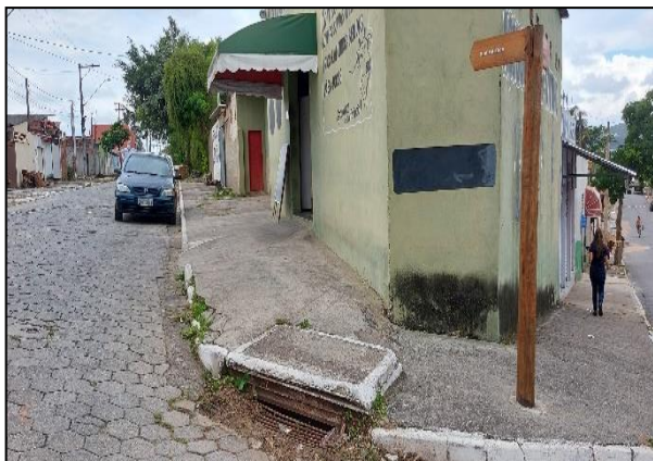
FIGURA 348 - BOCA DE LOBO NA ESQUINA DO MERC VITINHO FONTE: ACERVO DO AUTOR 2021
