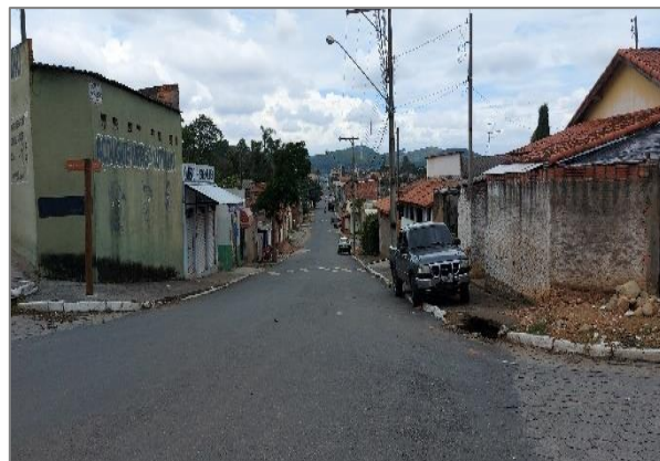
FIGURA 164 - BOCA DE LOBO NA ESQUINA FONTE: ACERVO DO AUTOR 2021
